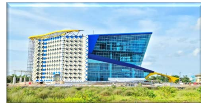
Gedung Kuliah Terpadu, UIN Sunan Antasari, Banjarmasin, Kalimantan Selatan
